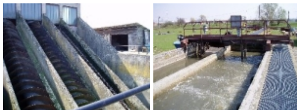
Slika 17. Uređaj za pročišćavanje otpadnih voda grada Kutine
